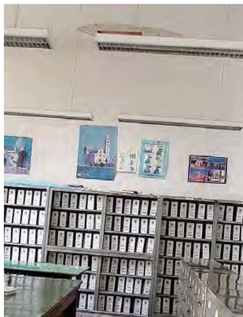
TRAGEDIA SFIORATA Calcinacci nell'ufficio elettorale
