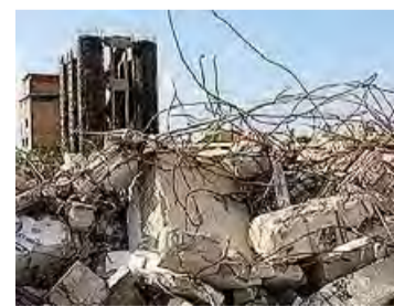
NORD BARESE Area degradata
