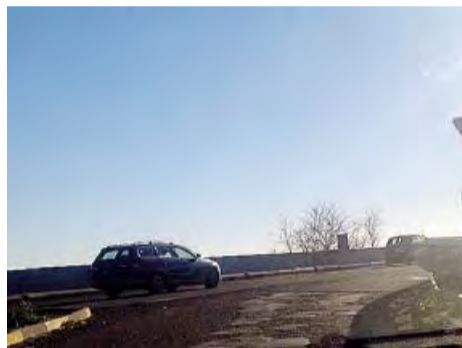
STATALE 16 BIS Degrado in agguato
