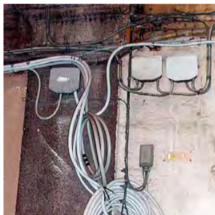
RETE ELETTRICA Nel mirino dei ladri
