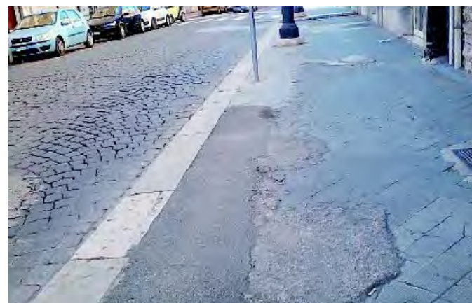
DISSESTATO Un significativo tratto del marciapiede di corso Cavour
