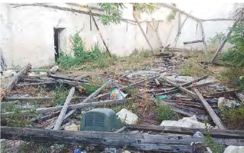
DEGRADO Ecco la situazione all'interno della villa
