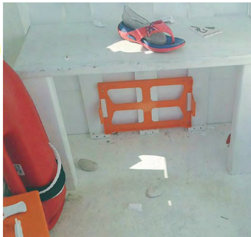
DANNEGGIATA L'interno della torre del servizio di salvataggio
